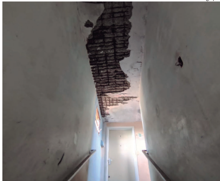
Imagem encaminhada por morador de prédio mostra teto que desabou nessa segunda
