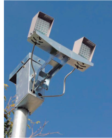
Radares estão em operação desde maio
