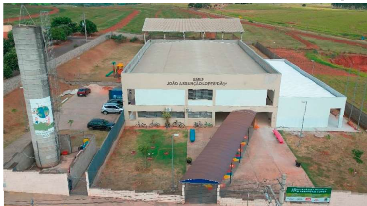
Emef 'João Assunção Lopes Dão' passa por finalização de obras para novas salas
