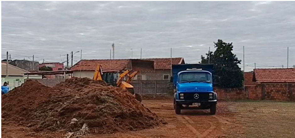
Unidade de saúde será construída no bairro Bandeirante; serviço de terraplanagem já teve início no local
