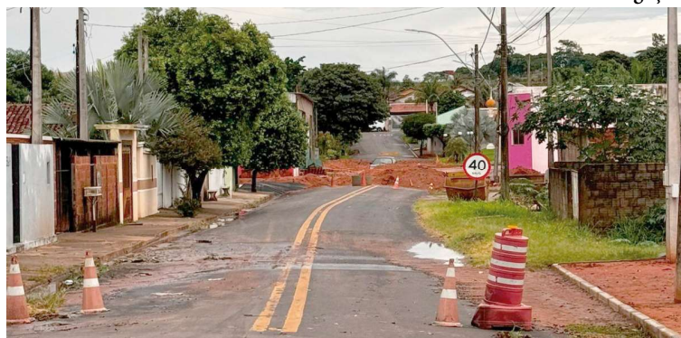
Ruas ficaram com lama na parte baixa da cidade; andamento da obra foi atrapalhado
