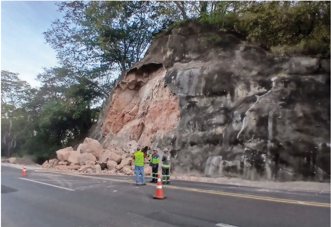
Deslizamento aconteceu devido às raízes das árvores que desprenderam as pedras
