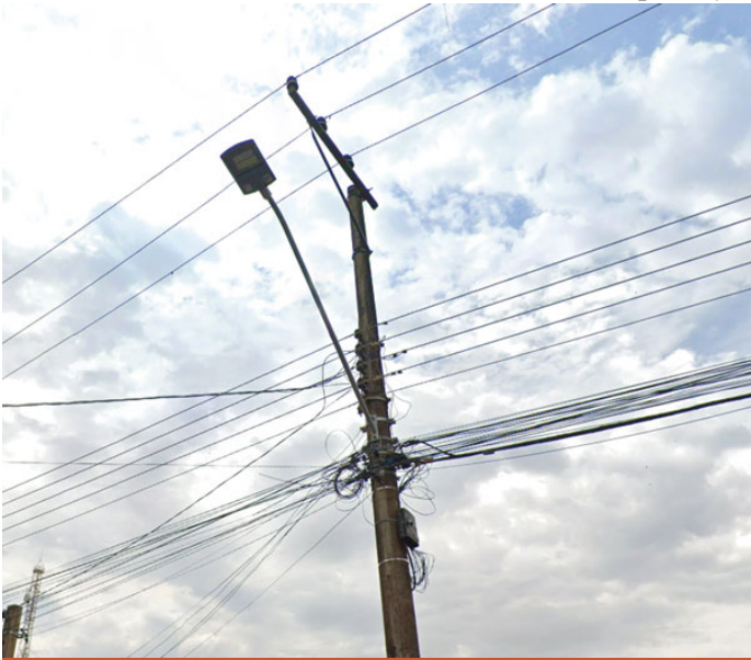
UBIRAJARA EXIGE REMOÇÃO DE FIOS P4
