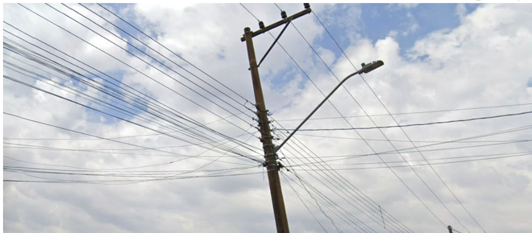
Poste na rua Ver. Antônio Mauro Briquezi; prefeitura exige remoção de fios inutilizados
