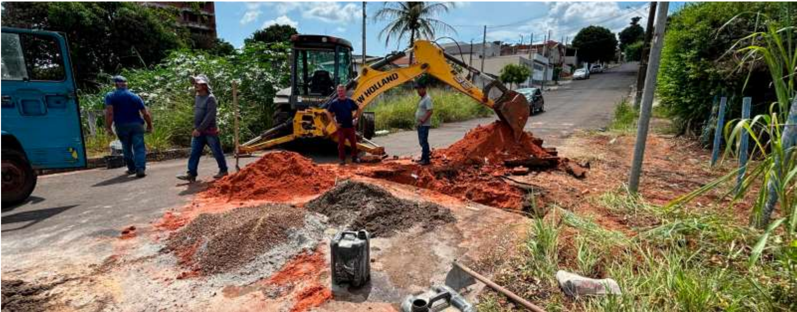
Secretaria Municipal de Infraestrutura de Marília atua contra erosão no viaduto da rua Rodrigues Alves, no Alto Cafezal
