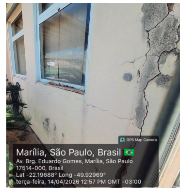
Esquadrias das janelas com corrosão
